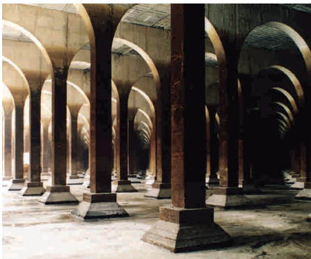
Depósito de cabecera.
